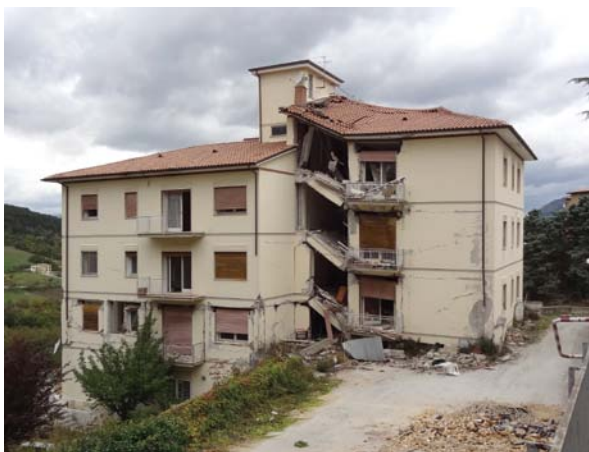
Επίσκεψη στην L'Aquila (σεισμός 6 April 2009, 5.9R)
