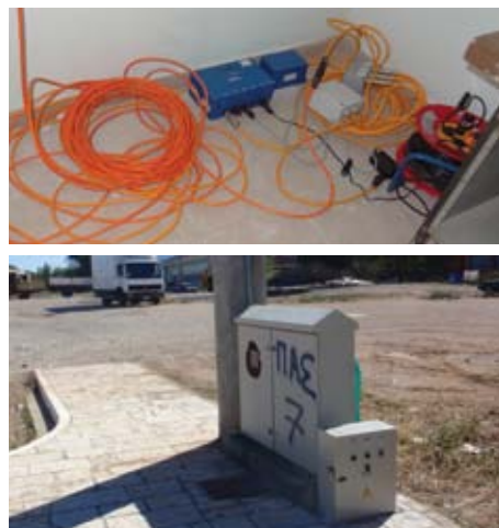
Εικόνα 23. Ενσύρματο πολυκαναλικό σύστημα επιταχυνσιομέτρων. Εγκατάσταση ψηφιακού επιταχυνσιογράφου σε πραγματικές συνθήκες ελεύθερου πεδίου
