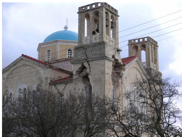
Εικ 4.6. Κύθηρα, σεισμός 2006. Βλάβες σε εκκλησία στο χωριό Μητάτα
