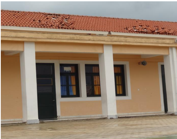
Αστοχίες εξωτερικών στοιχείων (μαντρότοιχοι, κεραμοσκεπές, καμινάδες, στέγαστρα κ.α.)
