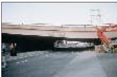
Κατάρρευση ανισόπεδου τμήματος ελεύθερης λεωφόρου (Σεισμός Northridge, Καλιφόρνια, 1994)
