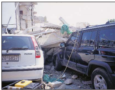
Αθήνα, σεισμός 1999. Η καταφυγή σε αυτοκίνητα ενδείκνυται μόνο αν παραμείνουν ακινητοποιημένα σε παρακείμενο χώρο στάθμευσης σε ασφαλή απόσταση από κτίρια, μαντρότοιχους κ.λπ.
