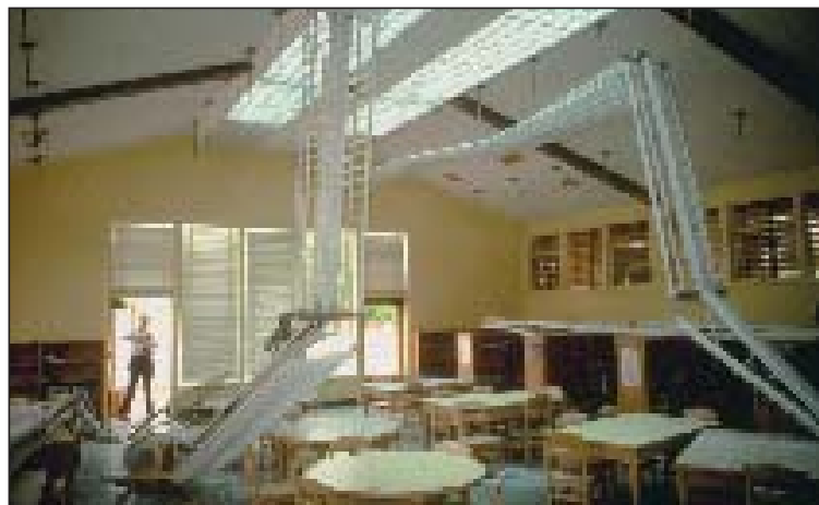
Σεισμός στην Coalinga, Καλιφόρνια, 1983: Εσωτερικές ζημιές σε σχολείο
