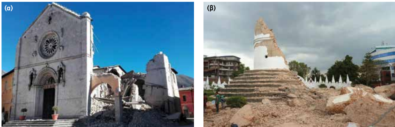
Εικ. 4 (α) Ο ναός του Αγίου Βενέδικτου στη πόλη Norcia στην Κεντρική Ιταλία μετά το σεισμό της 30ης Οκτωβρίου 2016 με μέγεθος M_w = 6.5 (Φωτογραφία από Καθηγητή Δρ. Ευθύμη Λέκκα, Norcia 2016) (β) Το Dhara-hara, επίσης γνωστό ως Πύργος Bhimsen, ένας εννιαόροφος πύργος κατασκευασμένος το 1834 καταστράφηκε ολοσχερώς κατά τη διάρκεια του καταστροφικού σεισμού του Νεπάλ στις 25 Απριλίου 2015 με μέγεθος M_w = 7.8 . (Φωτογραφία από Καθηγητή Δρ. Ευθύμη Λέκκα, Νεπάλ 2015) Πηγή: Παραδοτέο Δράσης Β - «BeSafeNet - Protect yourself from hazards»
