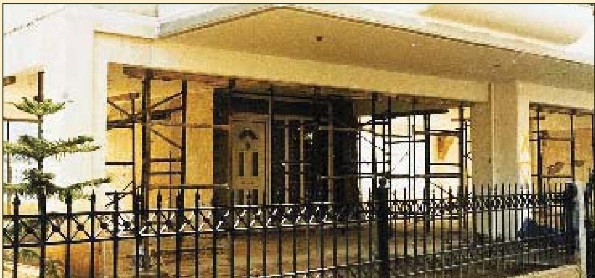
ΑΤΤΙΚΗ - ΑΝΩ ΛΙΟΣΙΑ - 1999 Υποστυλώσεις με βιομηχανικά ικριώματα σε διάροφη οικοδομή με Pilotis και ελαφρές ζημιές
