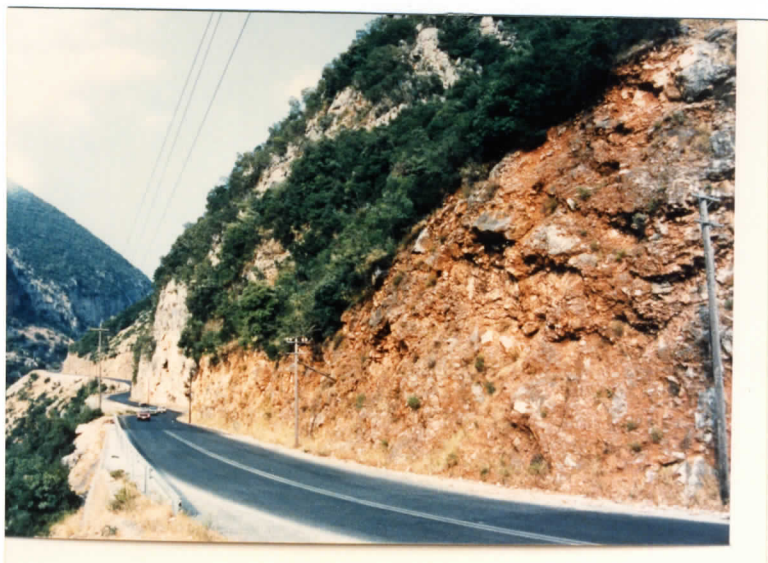
P20. ΧΘ 12,5. Πυκνοδιακλασμένος ασβεστόλιθος Τρίπολης. Συνεχείς καταπτώσεις βράχων διαφόρου μεγέθους. Στην περιοχή αυτή απαιτείται φράκτης ή δίκτυο.
