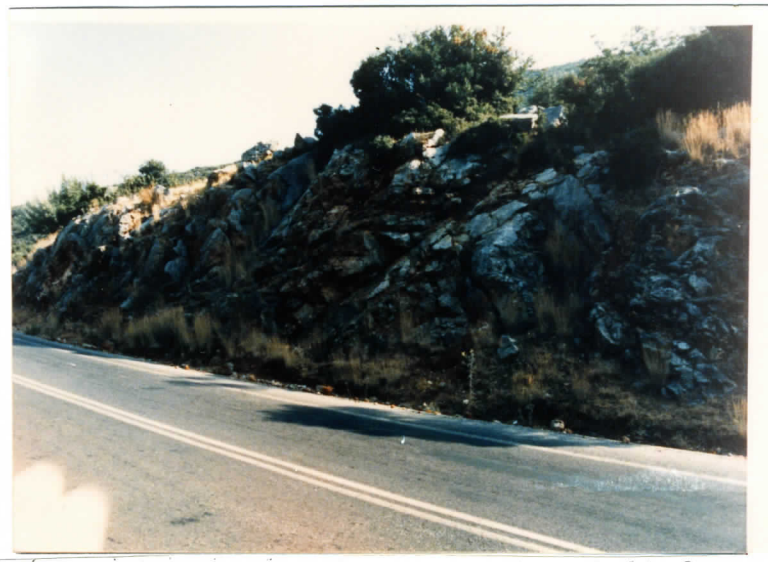
P11. ΧΘ 7,80. Διακλασμένος ασβεστόλιθος. Διακρίνονται μικρο-ολισθήσεις-καταπτώσεις από την κορυφή του πρανούς.
