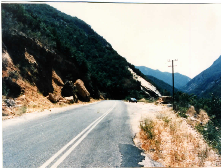
P31. Αστάθειες στα κορήματα ΧΘ 16.00 Στο βάθος διακρίνεται η ολίσθηση
