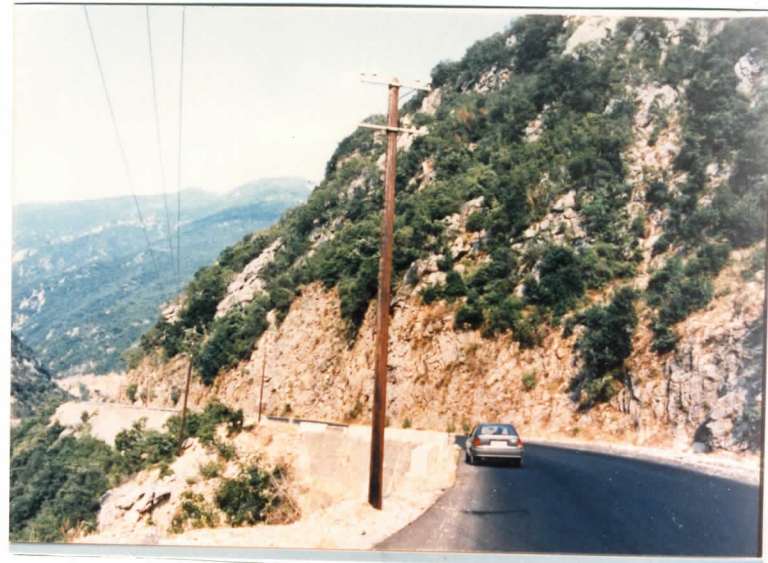
P21. ΧΘ 12,80. Γενική άποψη του δρόμου. Συνεχείς καταπτώσεις βράχων.
