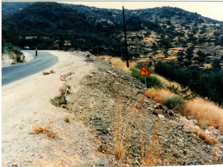
P4. Ολίσθηση επιχώματος στην ΧΘ 5,40 λόγω ύπαρξης υπόγειου νερού(πηγής)
