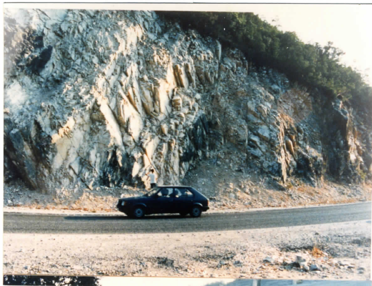
P34 ΧΘ17,70. Διακλασμένο πέτρωμα με τρία κύρια συστήματα διακλάσεων. Από το συνδυασμό των συστημάτων αυτών προκύπτουν αστάθειες διαφόρων μορφών κυρίως πτώσεις και ανατροπές. Απαιτείται Δίκτυ και στηθαίο.
