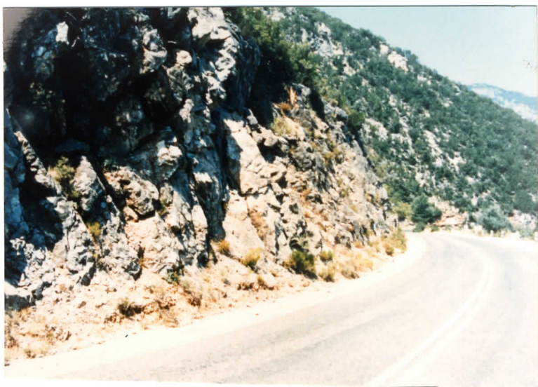
P52 ΧΘ 20,10.Ολίσθηση-Αποκόλληση
