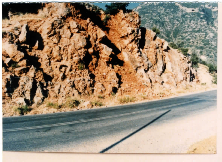
P58 ΧΘ 24,0 Περμικοί, ισχυρά καρστικοποιημένοι ασβεστόλιθοι. Καταπτώσεις, μικροολισθήσεις
