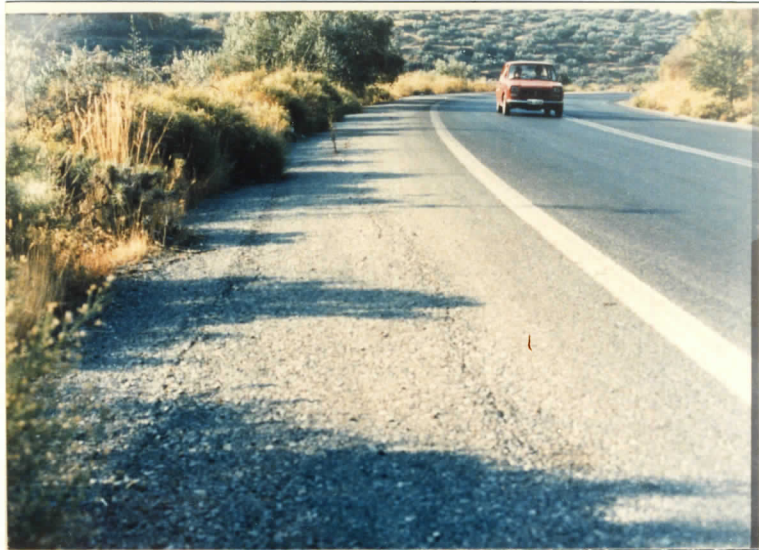
P3. Νέα ρωγμή στο κατάστρωμα του δρόμου στην περιοχή P1.
