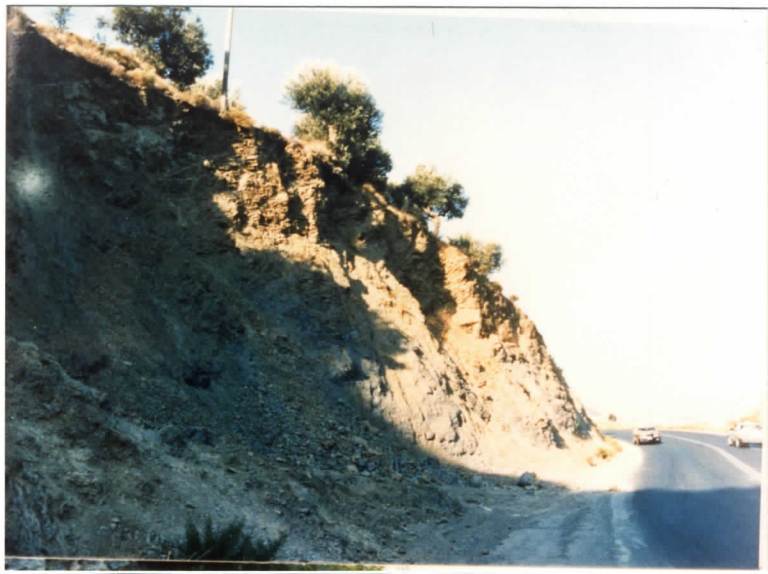
P10. Τεχνητό πρανές στο φλύσχη Τρίπολης. Διακρίνονται οι θέσεις των ρωγμάτων ΧΘ 7,20
