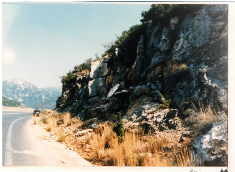
P12. ΧΘ 8,00. Διακλασμένος ασβεστόλιθος. Διακρίνονται μικρο-ολισθήσεις-καταπτώσεις από την κορυφή του πρανούς
