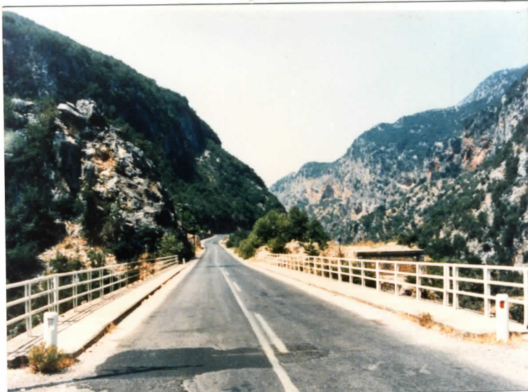
P23. ΧΘ13.00.Γέφυρα Καρβελιδτικού.Επικίνδυνος για πτώση μεγάλος βράχος στο αριστερό πρηνές.
