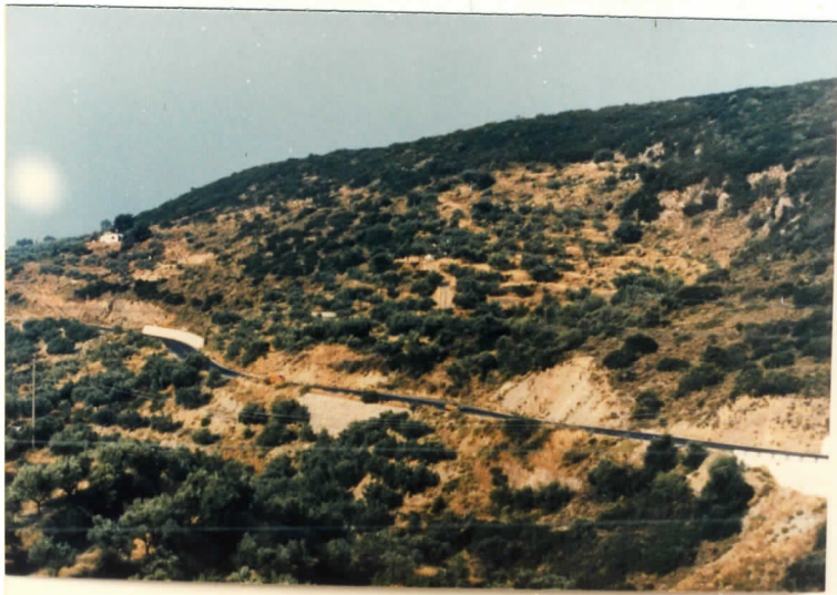
P1, Αστάθεια στο φλύσχη της Τρίπολης ΧΘ4,80. Διακρίνεται ο τοίχος αντιστήριξης.
