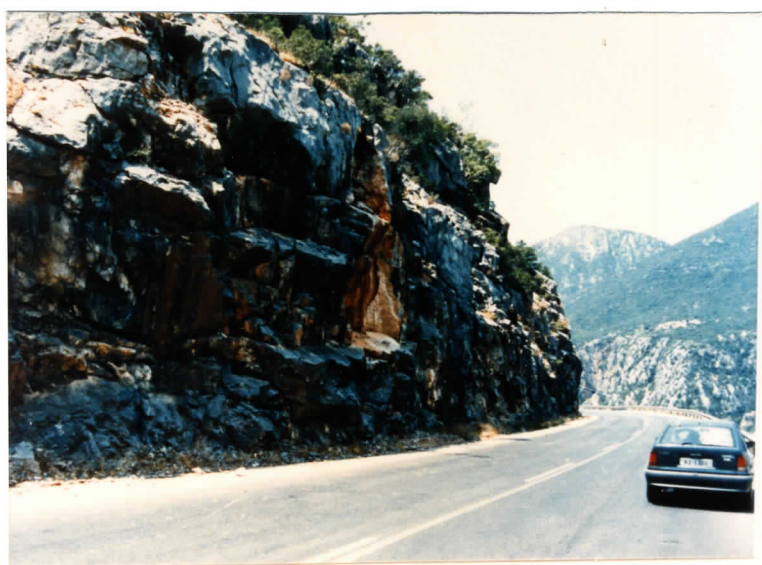
P14. ΧΘ 10.Καταπτώσεις από το σεισμό της 13-15/9/86.
