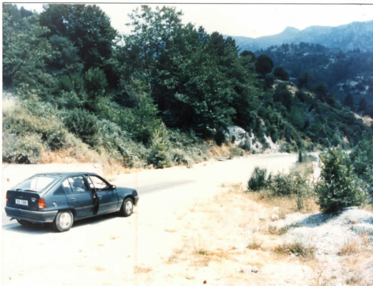
P59 ΧΘ 38,40. Αστάθεια στη σειρά των φυλλιτών, πιθανώς λόγω υπέρξεως υπόγειου νερού
