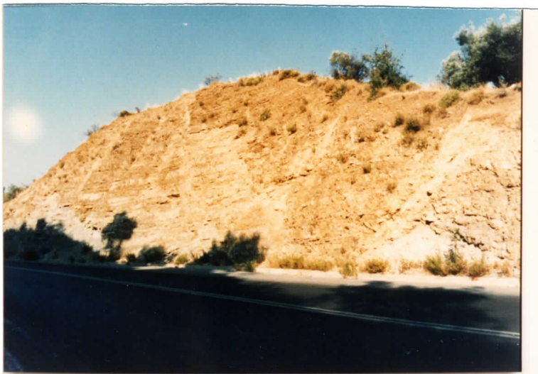
P9. Τεχνητό πρανές στο φλύσχη Τρίπολης. Διακρίνονται οι θέσεις των ρωγματώσεων ΧΘ 7,20
